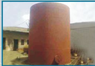
70 KL Storage Tank
